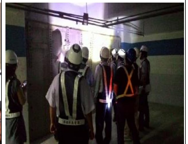
照片 4：第二次工程查核 A3 南區地下室剪力牆灌漿後施工檢視
