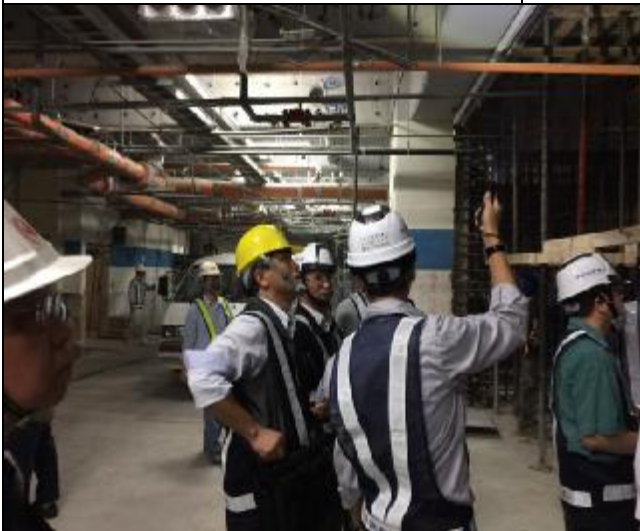
照片 5：第三次工程查核 A3 南區地下室 1 樓版補強施工檢視
