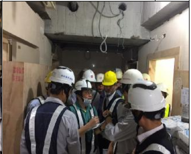
照片 6：第二次工程查核 A3 南區 I 棟 8 樓梯廳間補強施工檢視
