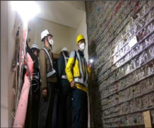
結構補強修繕第五次工程查核現場勘 查(A6 西區樓梯間牆)
