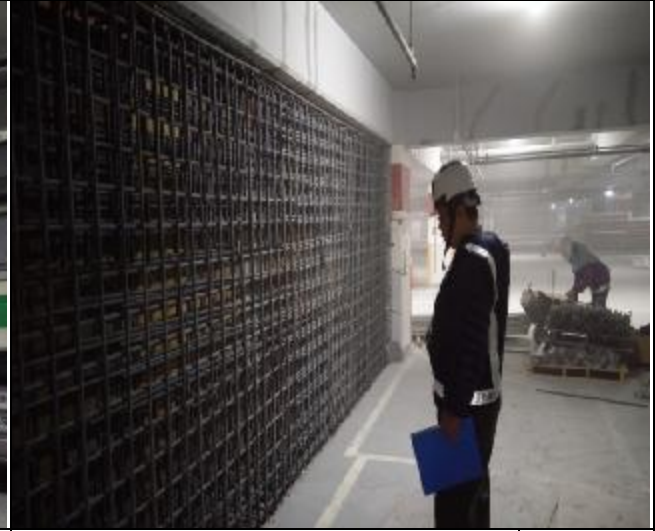
履約管理單位技師抽查 A6 東區地下室剪力牆施工狀況 1060321
