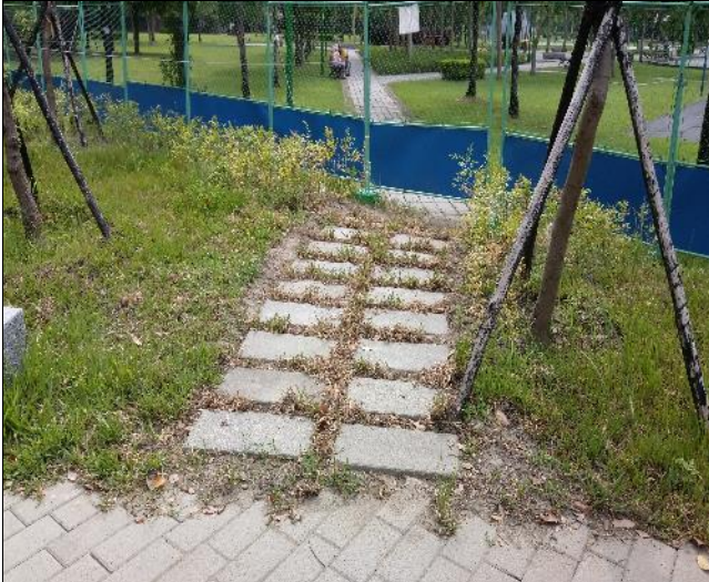
臺億公司辦理公八公園完工履勘缺失 改善施工督導
