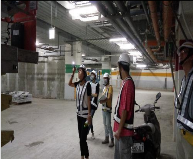
營建署辦理 A6 東西區 1 樓及地下樓結構補強工程竣工查驗 1060808
