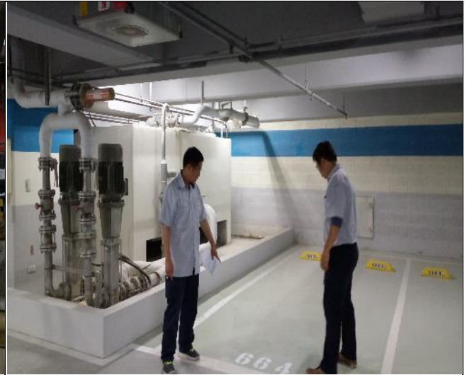
臺億公司辦理 A3 區裝修復原施工缺失督導
