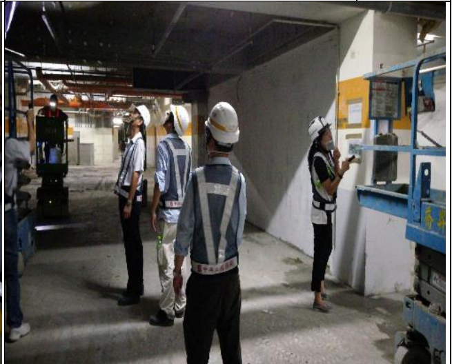
營建署辦理 A6 東西區 1 樓及地下樓結構補強工程竣工查驗 1060808
