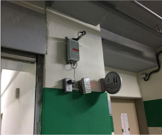
臺億公司辦理監檢測儀器-資料接收器 裝設督導 1070207
