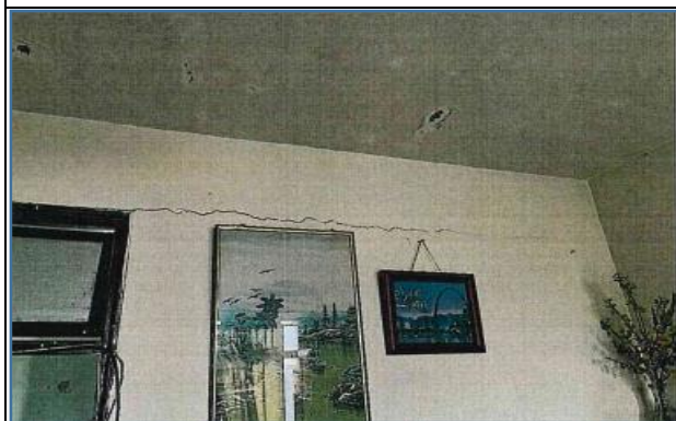
梁與磚牆界面裂縫
