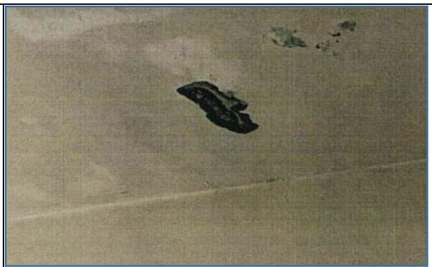
頂版滲水油漆剝落修補痕跡
