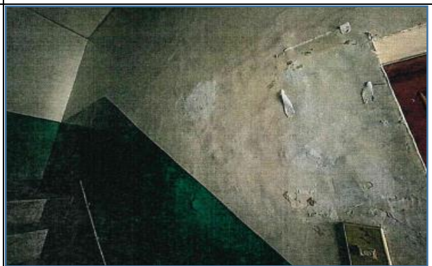
梯間滲水油漆剝落
