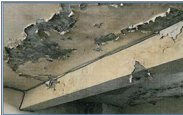
梁及頂版滲水油漆剝落
