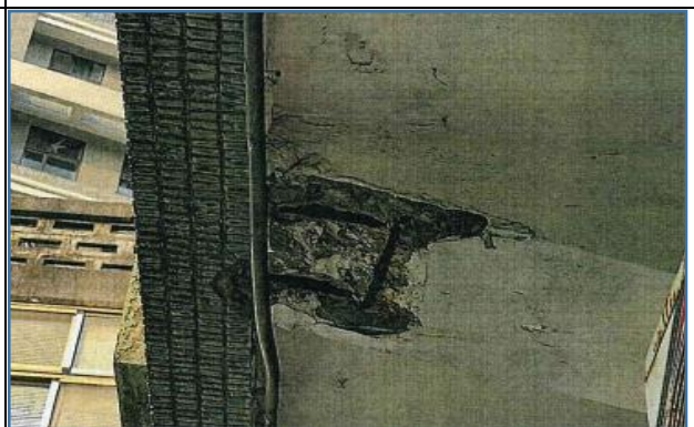
頂版混凝土剝落鋼筋鏽蝕
