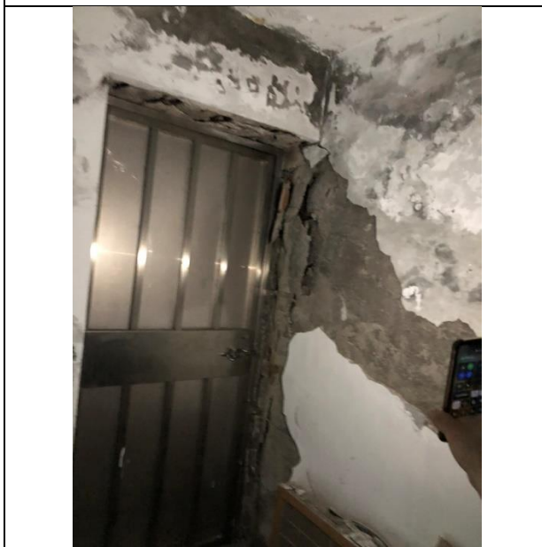
混凝土剝落、鋼筋鏽蝕、滲水
