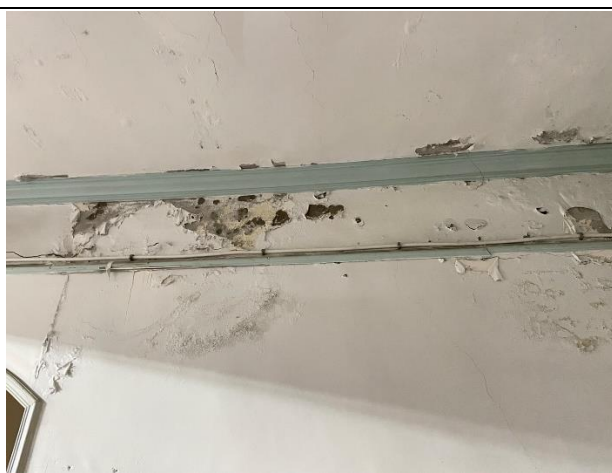
牆裂縫、混凝土剝落
