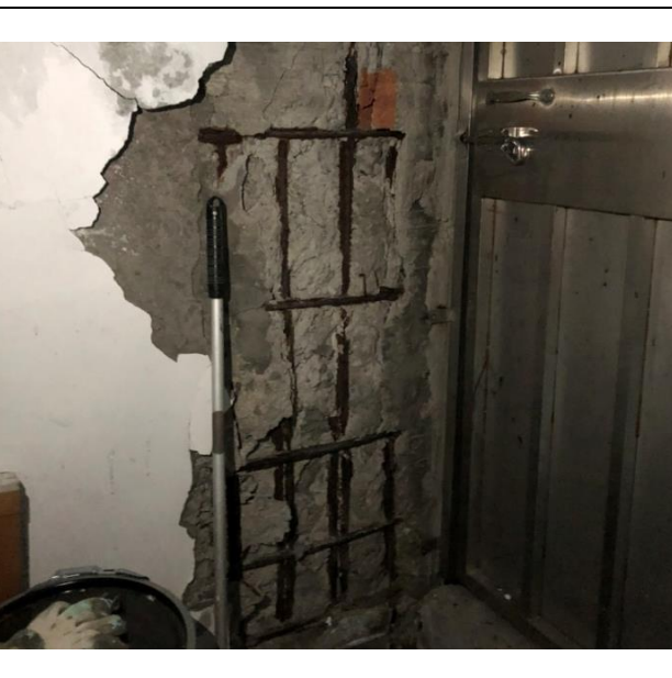
混凝土剝落、鋼筋鏽蝕
