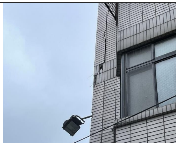
建築外牆裂縫、剝落
