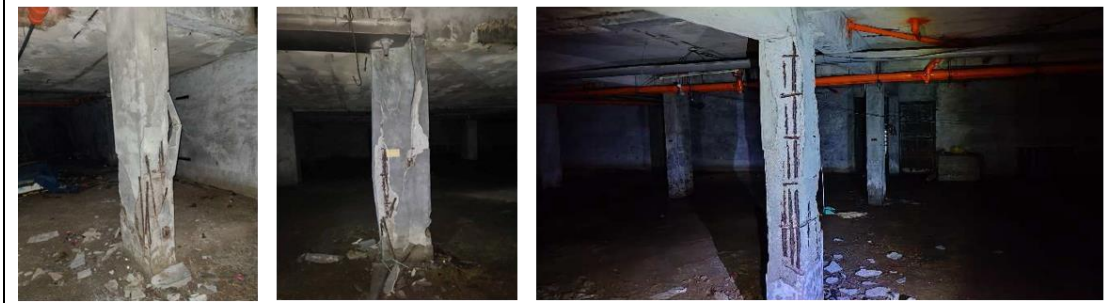
地下室柱保護層剝落/鋼筋銹
