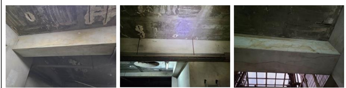
地下一樓屋頂大梁沿下層主筋方向發展縱向裂縫
