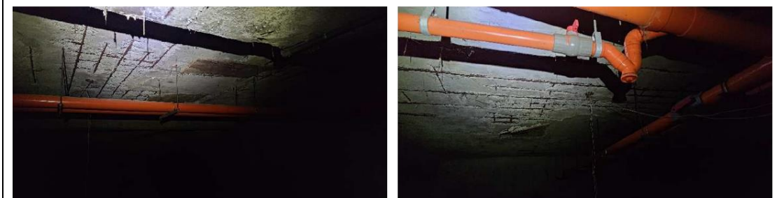
地下室板保護層剝落/鋼筋銹蝕
