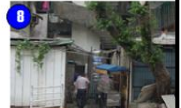
出入口違建增建情況嚴重
