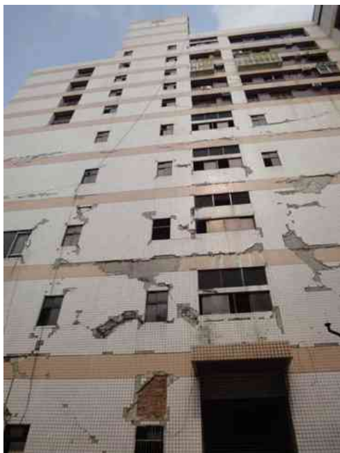
↑ 現況磁磚嚴重剝落
