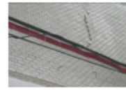
外牆立面龜裂
